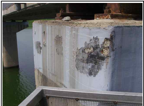
보수부 탈락 (P10)
