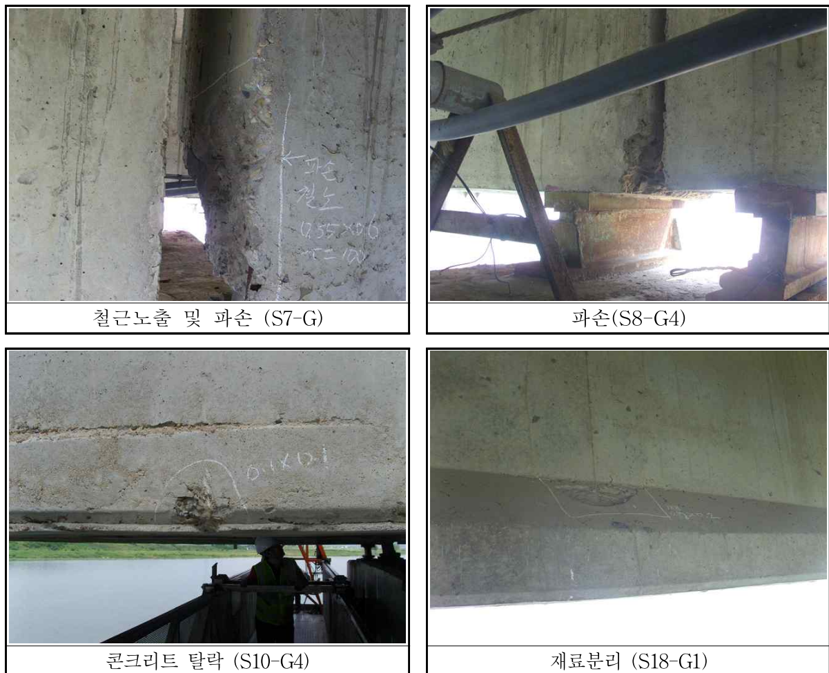
【그림 3.14】 거더(PSCI BEAM) 손상 현황
