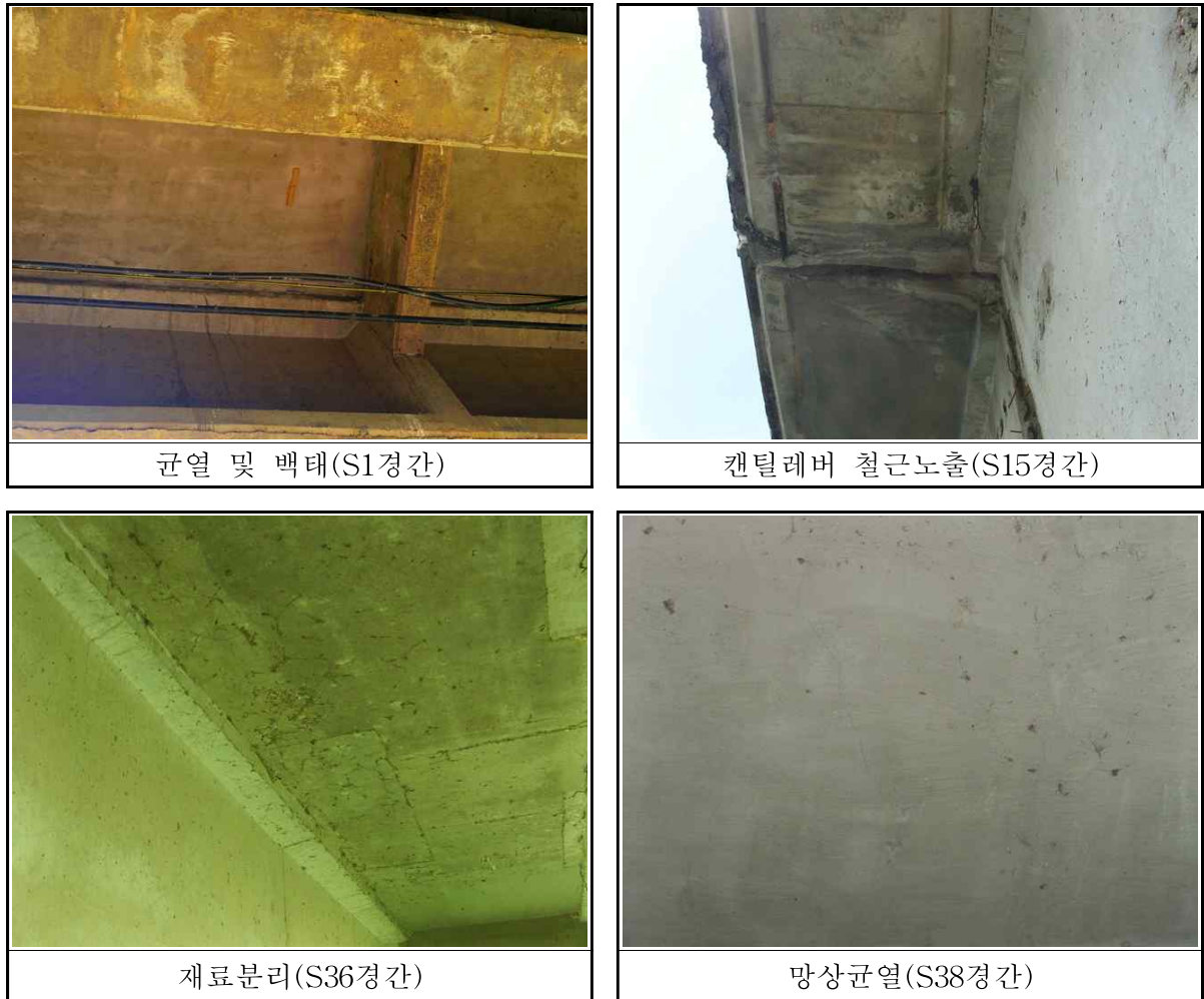
【그림 3.11】 바닥판하면 손상 현황
